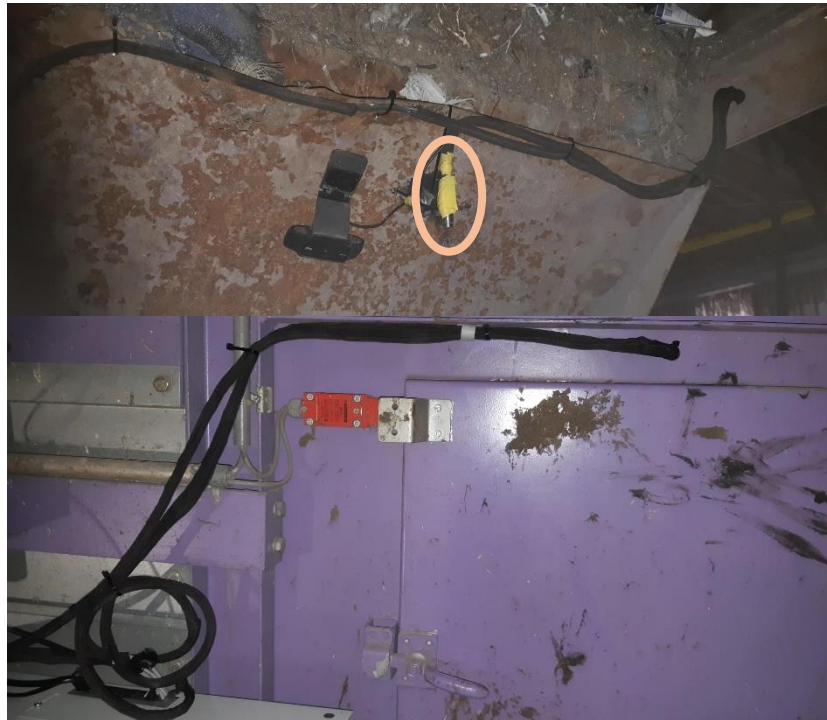
Mikrofon und Kamera auf das Prallblech ausgerichtet
